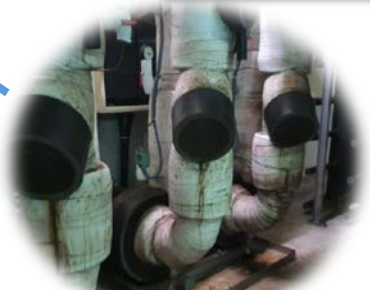
校正區域泵壓力表及變頻器
