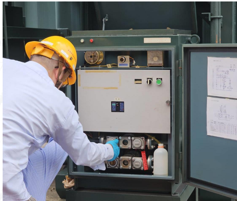
活線濾油機檢查
