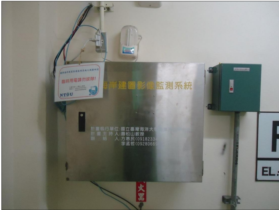
圖 3-17 觀測站主機機箱
