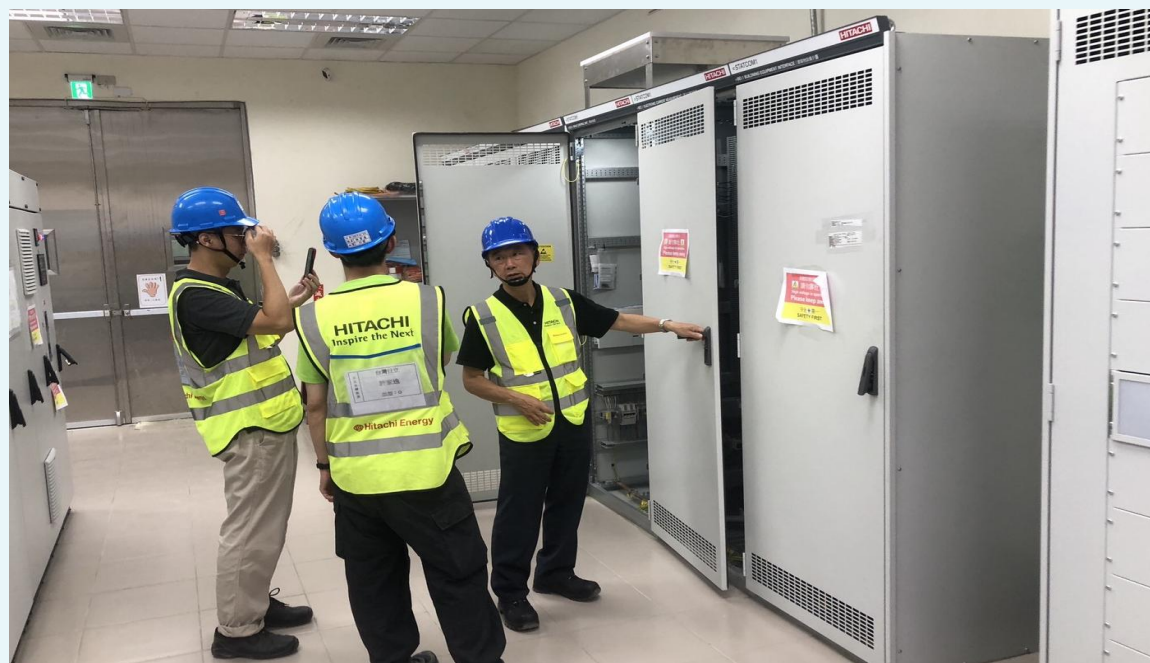
電氣室 STATCOM_SCADA訊號更新
