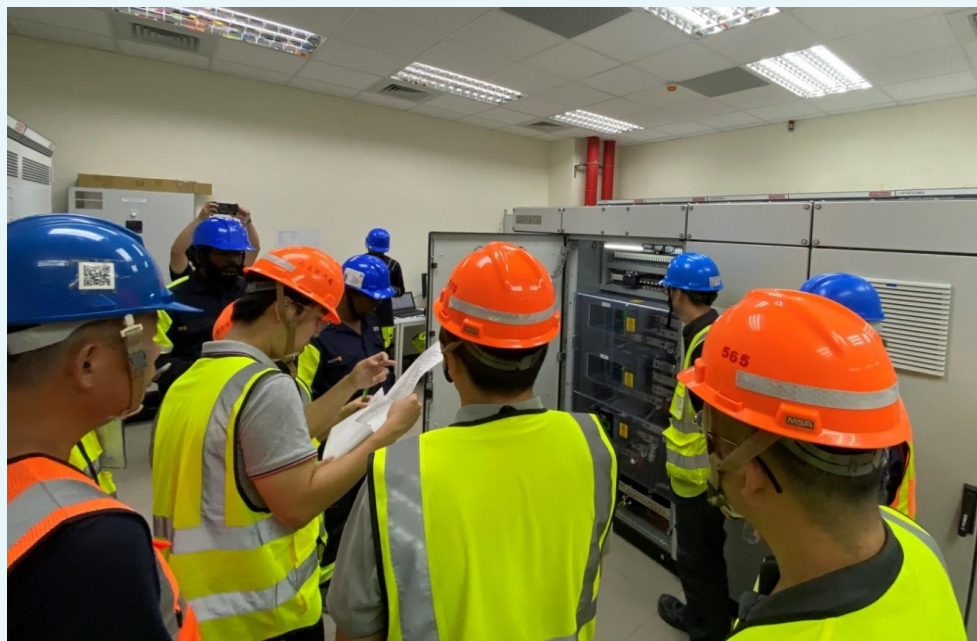
STATCOM#2 確認所內用電開關狀態
